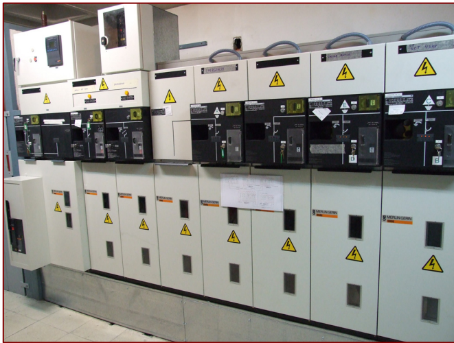
Detalle de celdas de media tensión.
