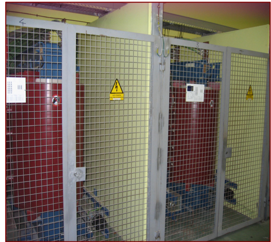
Detalle de transformadores de MT.
